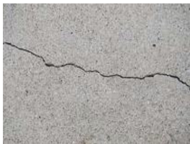
Рис.1. Трещина на дороге «Одесса-Мелитополь- Новоазовск»
