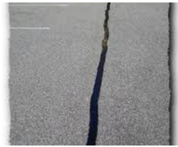
Рис.4. Трещина после ремонта
