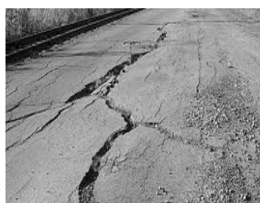
Рис.2. Разрушение дороги «Ульяновка – Николаев»
