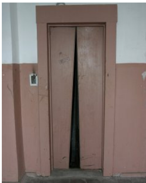
Рис. 1. Деформация дверей шахты лифта
